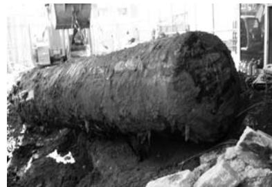
掘り出したタンク。アスファルト防水の劣化状況がよく分かる。
