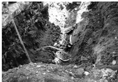
タンクを掘り出した跡。かなりの油膜が認められる。
